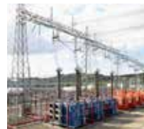
Subestação Conversora do Songo
