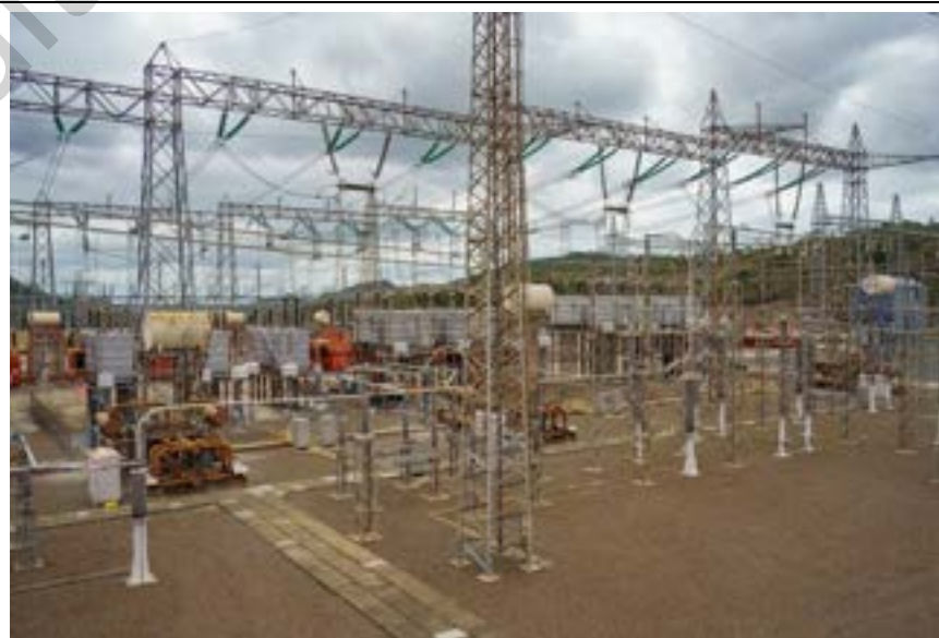
14. Subestação de Songo.
