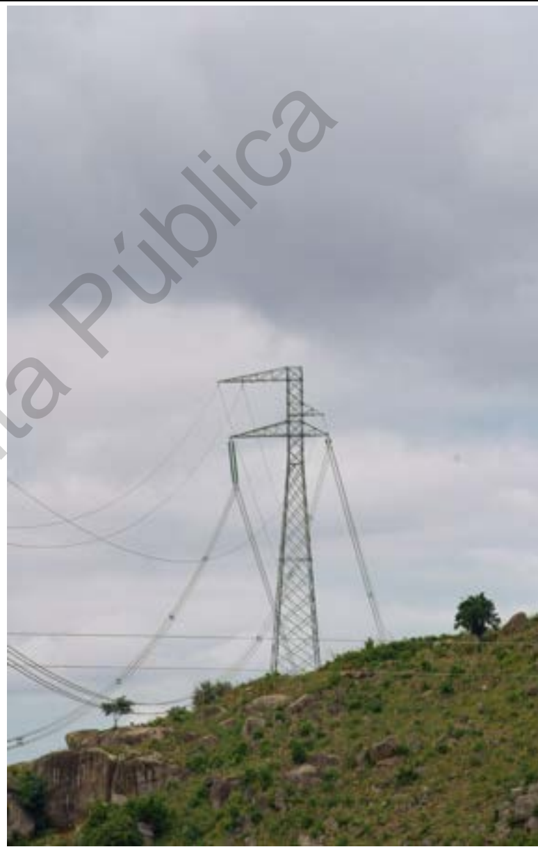
18. Linhas de transmissão à saída da subestação de Songo
