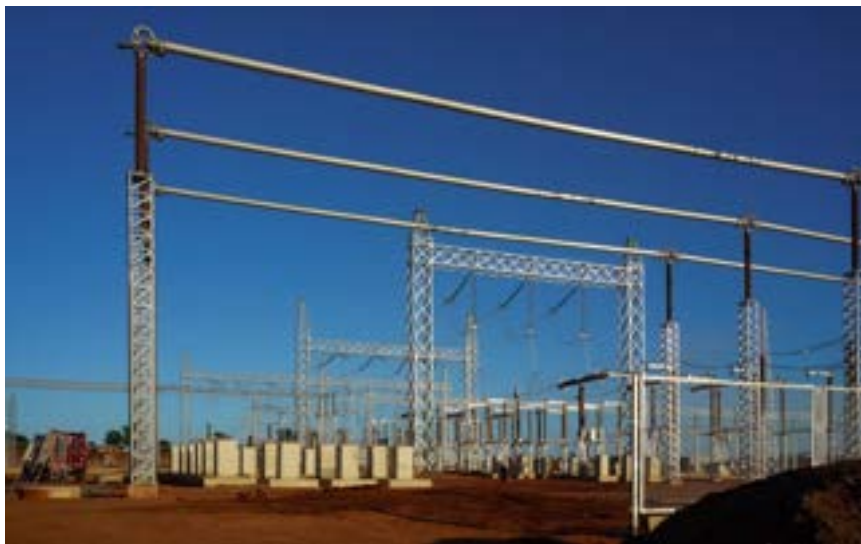
35. Subestação de Matambo substation (Parte nova).
