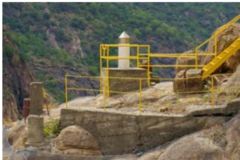
3. Dispositivo de monitoramento da barragem na margem sul.
