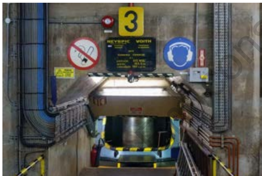
9. Grupo Gerador nº 3.
