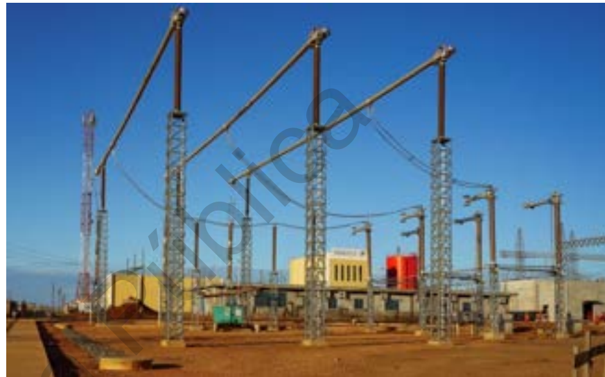
36. Substação de Matambo (parte antiga, reabilitada).
